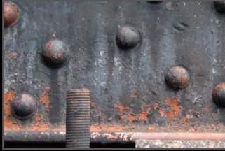
塗膜のはく離やさびの原因
